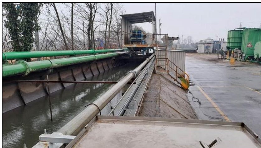
Fig. 4.2 foto del "canalone" per raccolta acque meteoriche e filtropressa
