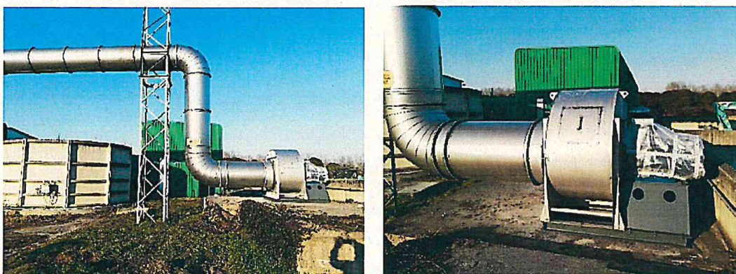
Figura 6: Foto delle tubazioni e del ventilatore centrifugo installati.
