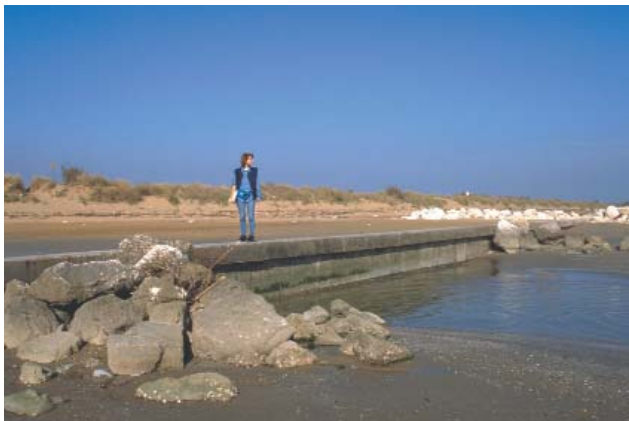
Fig. 4.121. Esempio dell'effetto di sovraescavazione operato dal moto ondoso alla base della palancola cementizia lungo il litorale della laguna del Morto. Lo stesso fenomeno si può osservare lungo gran parte del tratto costiero di Valle Altanea ed Eraclea (1997).
