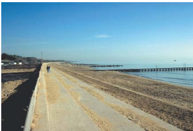
Fig. 4.116. Le difese radenti lungo il litorale di Valle Altanea. La spiaggia è relegata a una fascia pensile immediatamente alle spalle della gradonata cementizia e a una sottile striscia verso mare, oltre la palancola verticale, di cui si scorge la sommità. Le difese trasversali sono date da pennelli permeabili a forma di pontili e da pennelli in massi (1997).
