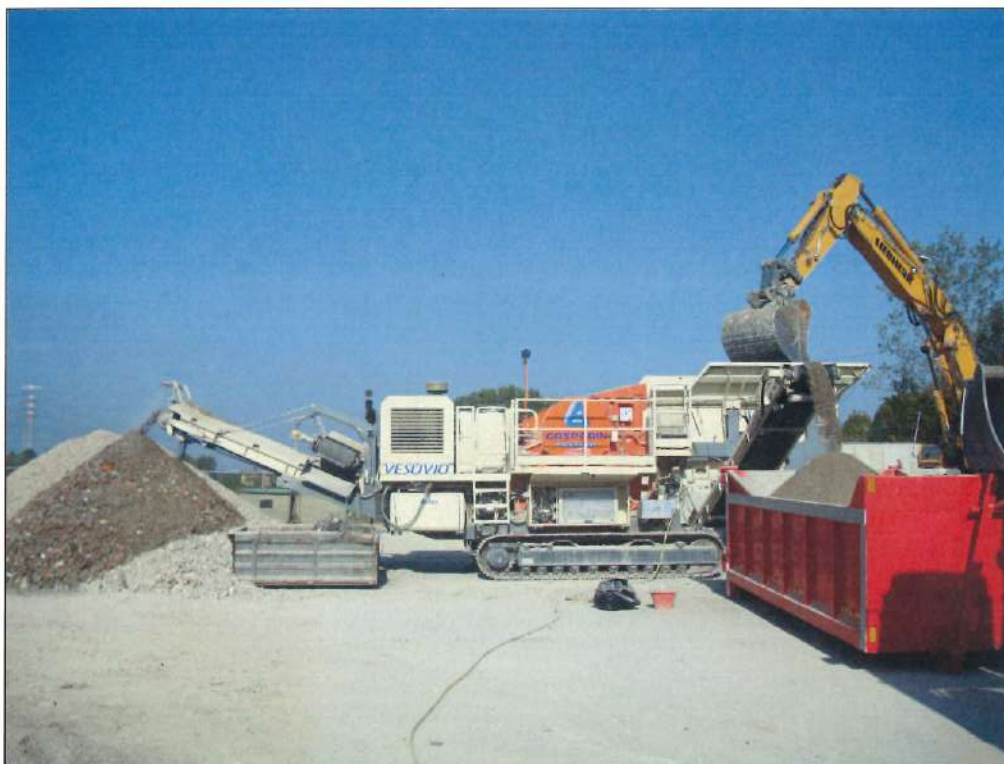
Impianto di frantumazione e vaglio
