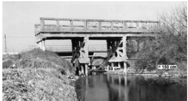
Fig. 6.1 - Un ponte costruito circa nel 1920 mostra una protrusione della fondazione pari a 150 cm corrispondenti alla subsidenza avvenuta per compattazione in seguito all'ossidazione dei terreni torbosi e da pompaggi di acque sotterranee. Sullo sfondo il nuovo ponte, che risale agli anni '70, evidenzia l'abbassamento del suolo, di circa 30 cm, avvenuto negli ultimi trent'anni (fonte: CONSORZIO DI BONIFICA ADIGE BACCHIGLIONE, ora ADIGE EUGANEO).
