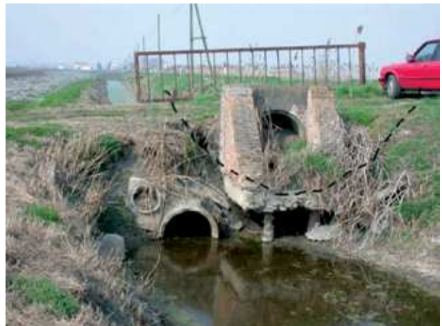
Fig. 6.2 - Condotta di collegamento sotterranea a mattoni attualmente sopra il livello dell'acqua e sostituita da due tubi di scolo in cemento collocati più in basso, il più elevato dei quali risulta già inutilizzabile. La linea tratteggiata raffigura l'ubicazione originale della sezione della vecchia condotta (fonte: CONSORZIO DI BONIFICA ADIGE BACCHIGLIONE, ora ADIGE EUGANEO).
