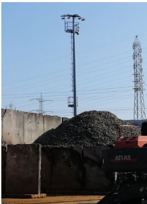
Torre Faro 2 con n.5 corpi illuminanti
