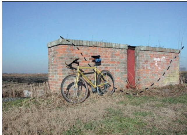
Figura 3.11 – Bacino Zennare: una vecchia chiusa abbandonata, costruita negli anni '930 per controllare un canale di scolo, è oggi completamente protrusa sopra il piano campagna. Rappresentazione della sezione della vecchia fognatura secondo quella che doveva essere la sua ubicazione originale [49].
