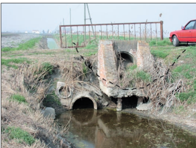
Figura 3.10 – Bacino Zennare: condotta di collegamento sotterranea a mattoni costruita negli anni '930, attualmente sopra il livello dell'acqua e sostituita inferiormente da due tubi di scolo in cemento, il più elevato dei quali già inutilizzabile. Rappresentazione della sezione della vecchia condotta secondo quella che doveva essere la sua ubicazione originale [49].
