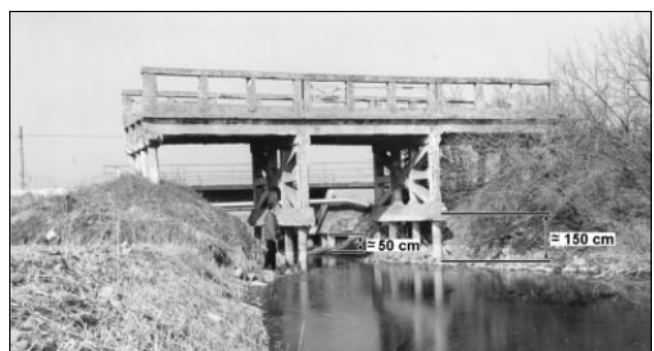
Figura 3.9 – Un ponte costruito negli anni 1920 mostra la protrusione della sua fondazione di circa 150 cm. Questa subsidenza fu indotta dalla compattazione per ossidazione dei suoli torbosi e da pompaggi di acque sotterranee. Sullo sfondo il nuovo ponte, che risale agli anni '90, evidenzia un abbassamento del suolo di circa 50 cm avvenuto negli ultimi trent'anni [77].
