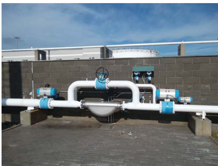
Esempio di misuratore massico su linea carico serbatoi da banchina
