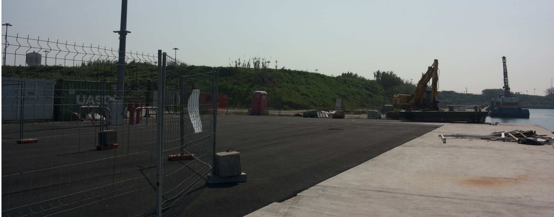
Figura 5 – La vecchia discarica limitrofa al sito di progetto (vista dalla banchina), su cui è già stato approvato un progetto di bonifica che, sostanzialmente ne prevede la rimozione ed il trattamento dei rifiuti presenti.
