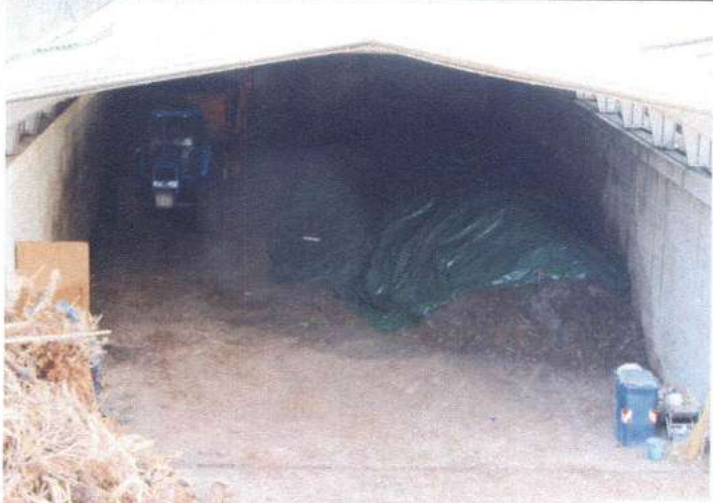
Foto 3 - vasca in calcestruzzo per biossidazione
